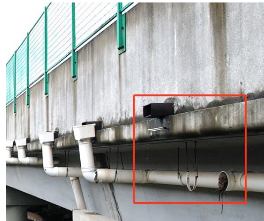
图 3-4: 雨水斗、横向引水管缺失
