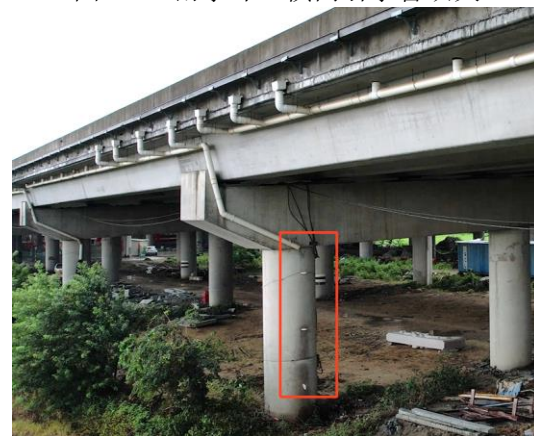
图 3-6: 竖向排水管缺失
