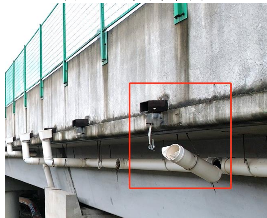
图 3-5: 横向引水管脱空
